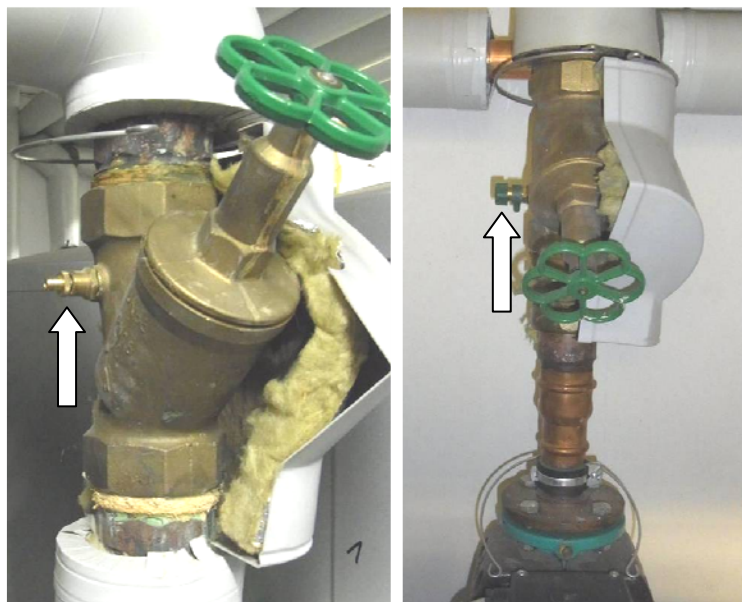
Abbildung 11: Absperrarmatur mit Möglichkeit zur Nachrüstung einer Probenahmestelle (Quelle: degewo)
